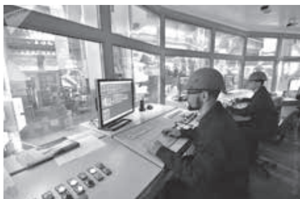
Рисунок 13 — Кабина управления автоматизированной линией на ОАО «МПЗ» Figure 13 — Automated line control cabin at JSC “MPZ”
